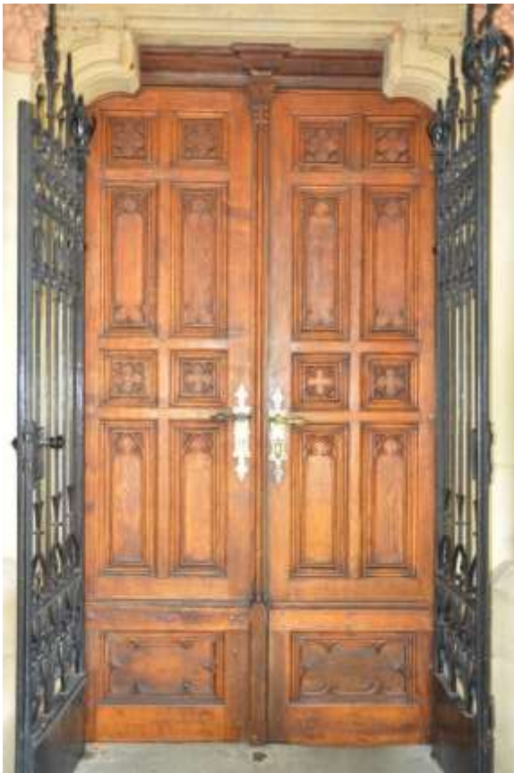
Západní vchod, vnější pohled, nepůvodní laková vrstva, ve spodní části viditelné opravy.
