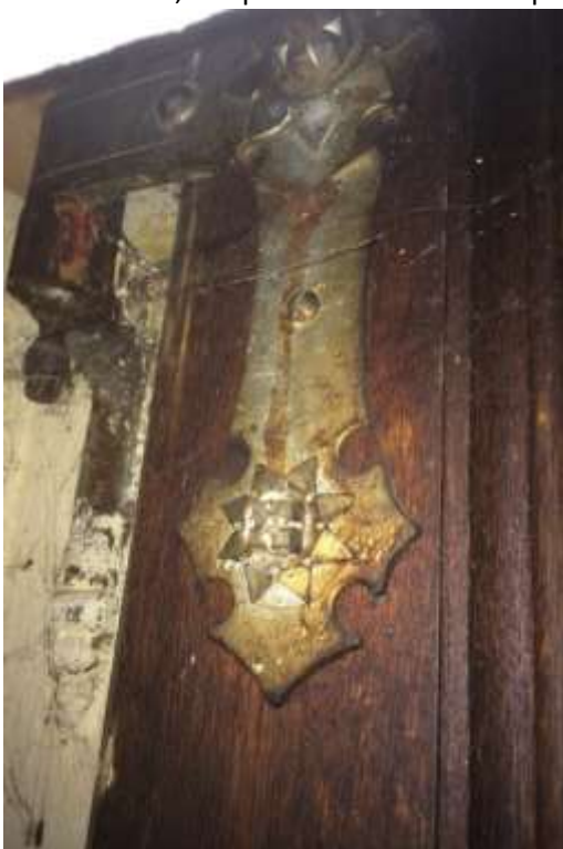
Severní vchod – detail pravého spodního závěsu dveří zevnitř. Na kovu je patrná zchovalá vrstva stříbrného odstínu, pravděpodobně cínování. Lokálně překryta ztmavlým nátěrem.
